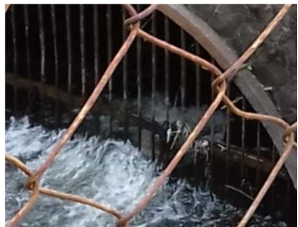
Gambar 6. Sampah yang menyumbat saluran masuk air ke pipa penstoct .
